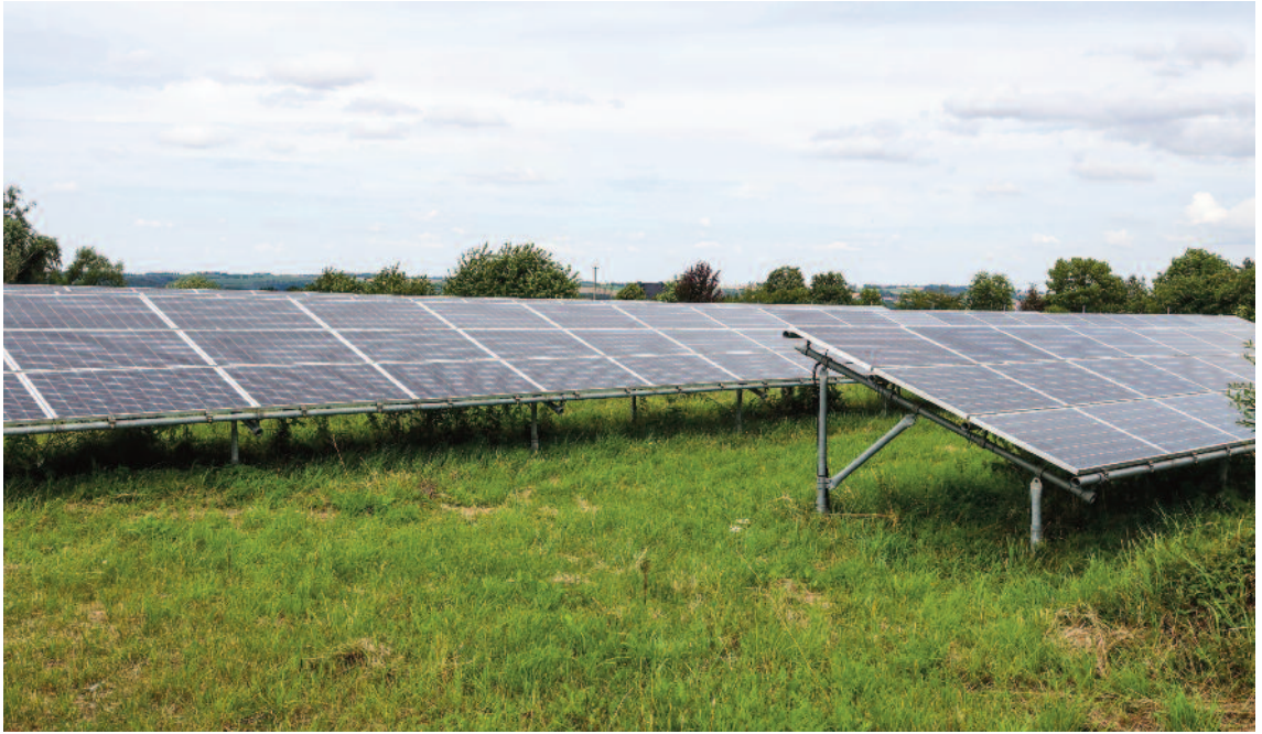
Photovoltaikanlage in der Nähe von Roßwein
